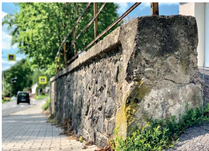
Zídka je ve špatném stavu, čeká ji oprava.
