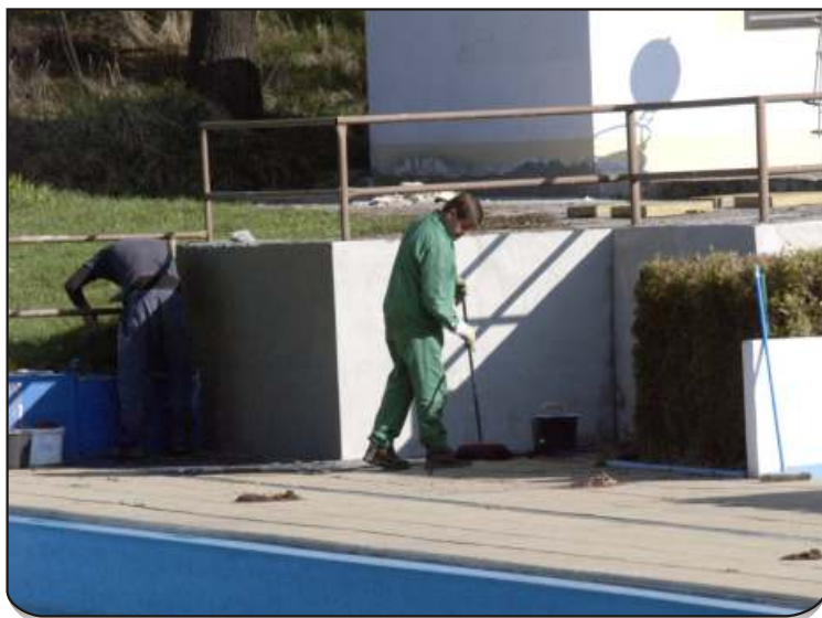
Areál potřebuje předsezónní opravy
