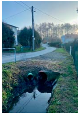
Na Mlýnoze. Letos chce obec nechat opravit zdejší poškozený propustek.
