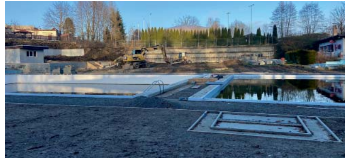
Bazény už jsou v novém, na koupališti se teď budují třeba rozvody energií.
